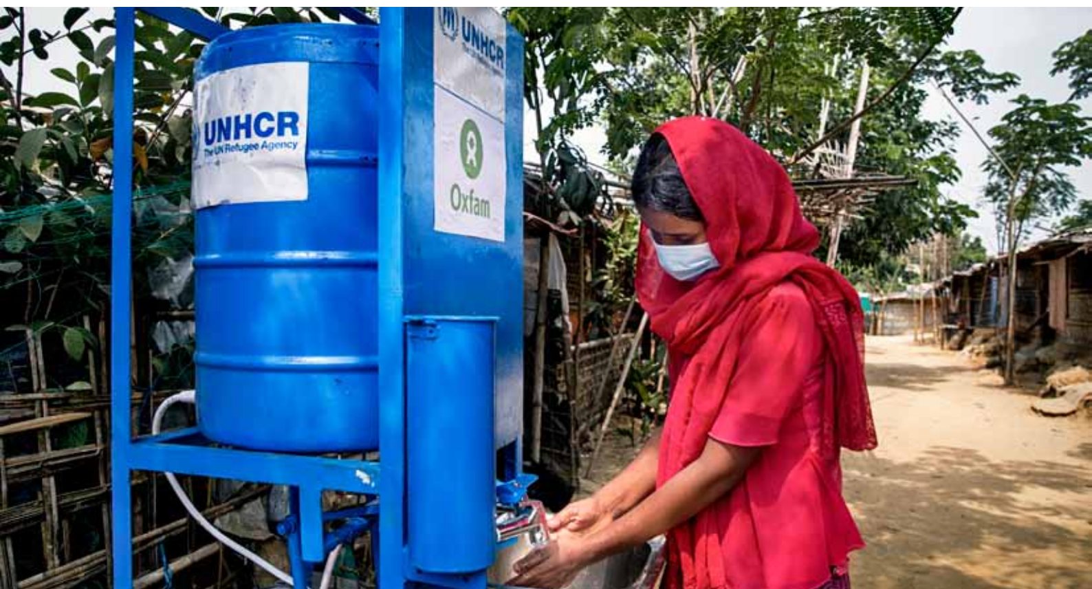
Station de lavage pour les mains sans contact à Cox's Bazar dans un camp de réfugiés Rohingyas au Bangladesh © Oxfam/ Fabeha Monir
